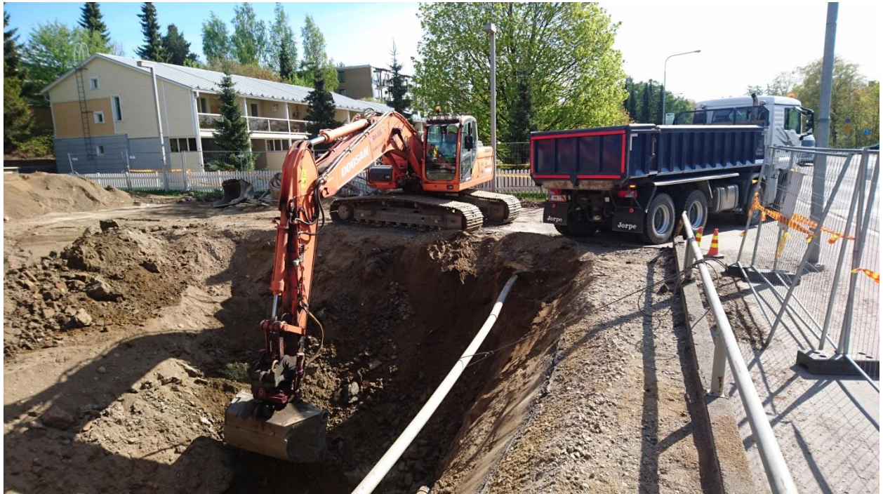
Kuva 3. Säiliökaivannon pilaantuneet maa-ainekset sijaitsivat Messukylänkadun ja lähimmän säiliön välissä. Kaivut ulottuivat tutkimuksessa todetun pilaantumisen alueelle.
