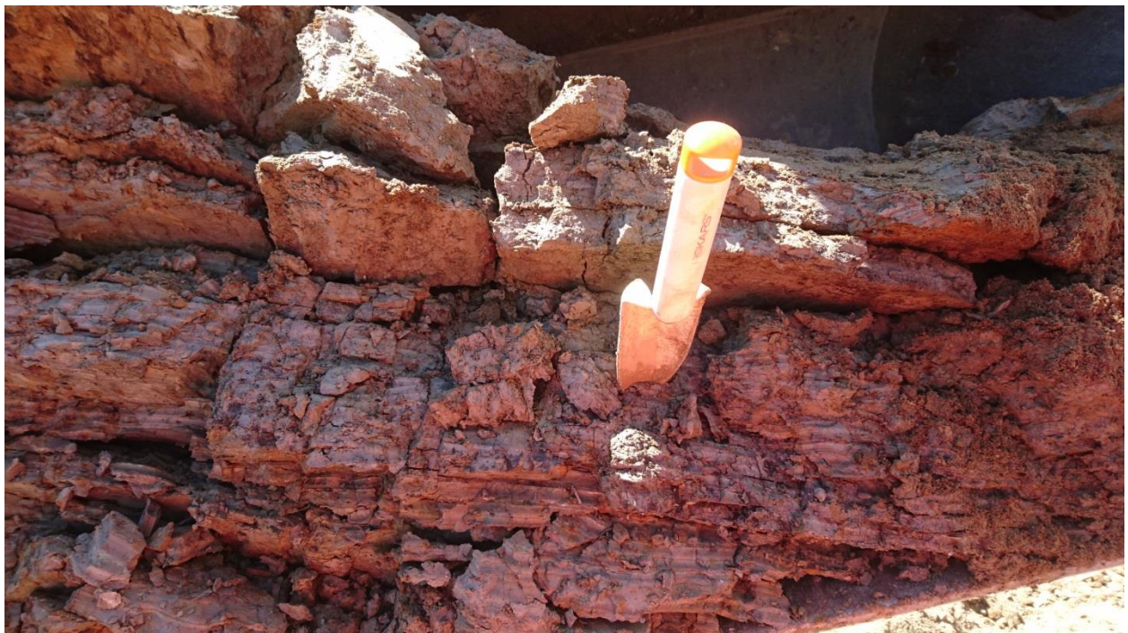
Kuva 4. Säiliökaivannon Messukylänkadun puoleisella alueella öljyhiilivetypitoiset maat sijaitsi savi/silttikerroksessa, joka alkoi noin 2 m syvyydestä.
